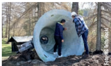
Die alte Friedensglocke beim Abbau. Sie weist mehrere Risse auf.
