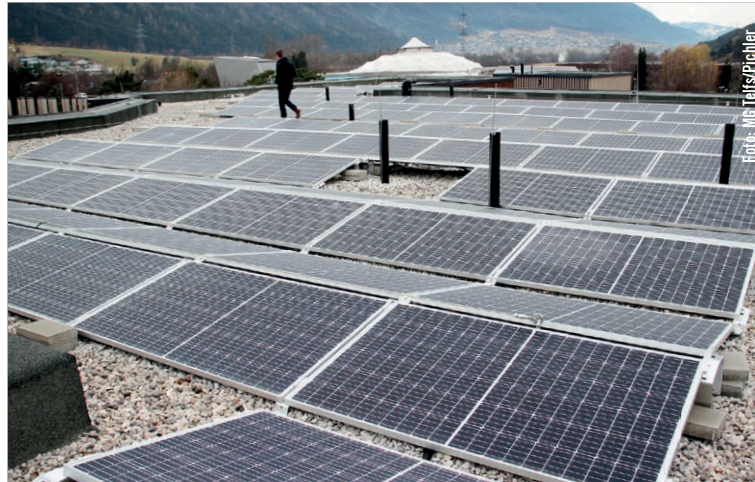
Der Ausbau von Photovoltaik auf privaten Dächern ist angesichts der privilegierten Sonnenlage von Telfs ein Gebot der Stunde. Die Gemeinde geht mit gutem Beispiel voran, wie hier am Telfer Bad.
