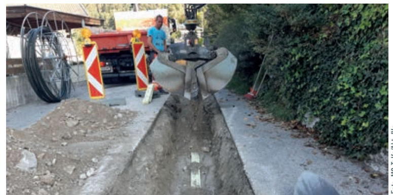
Rund eine Million Euro fließen jährlich in Straßensanierungen und -erweiterungen am Gemeindegebiet. Dazu kommen unvorhersehbare Schäden, die schnell saniert werden müssen.
