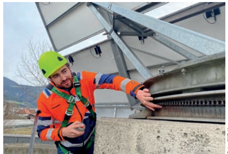
GW Telfs-Kraftwerksspezialist Gabriel Schöpf bei der Wartung des Movers.
