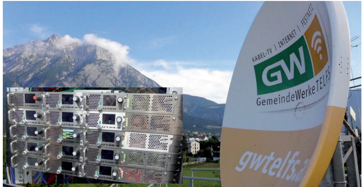
Die Kabel-TV-Empfangsanlagen der GemeindeWerke sind auf dem neuesten Stand der Technik.
